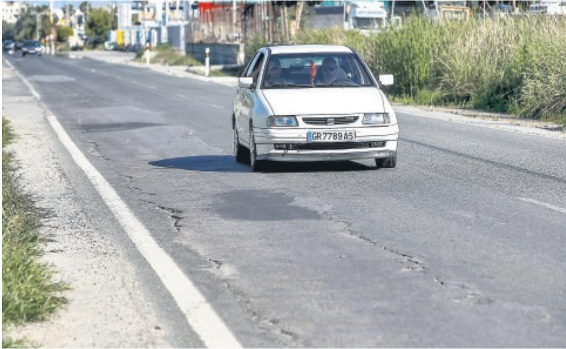
Baches y grietas en una carretera dependiente de la Junta en la provincia de Granada
